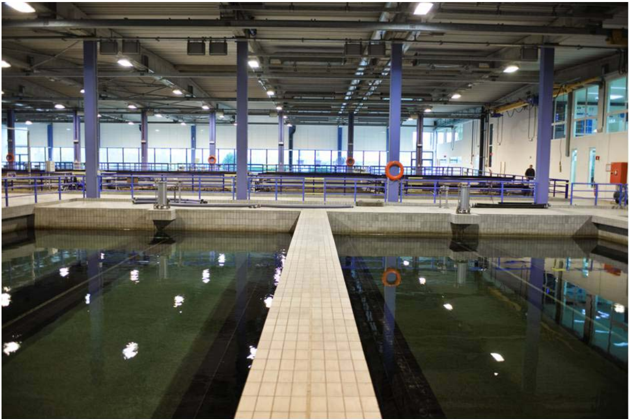
Station de traitement de STEMBERT (SWDE)
