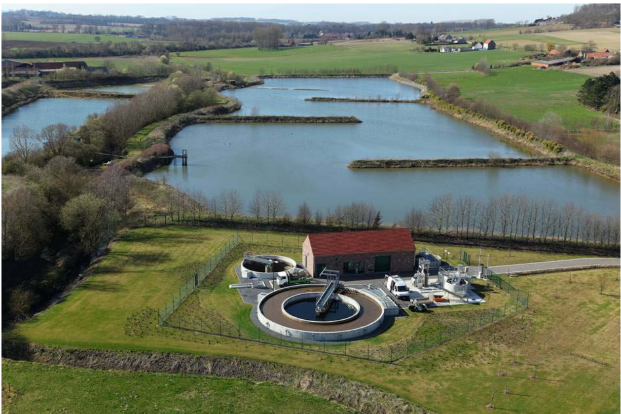
Station d'épuration de FRASNES-LEZ-ANVAING (IPALLE)
