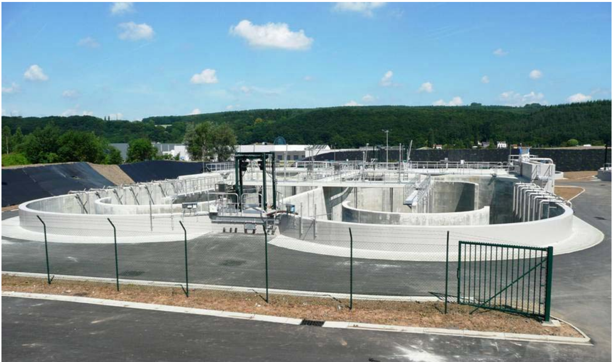
Station d'épuration d'ANDENNE (INASEP)
